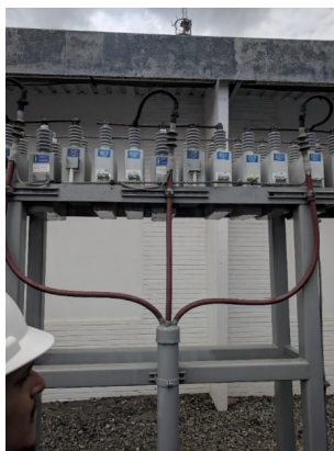
Figura 6: Banco de capacitores
