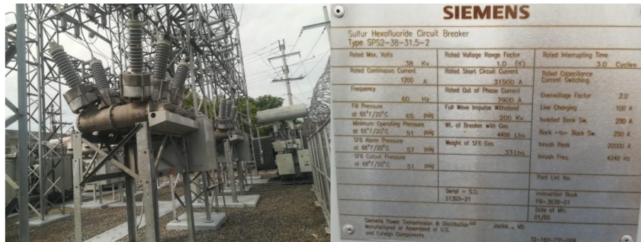
Figura 4: Interruptores y placa
