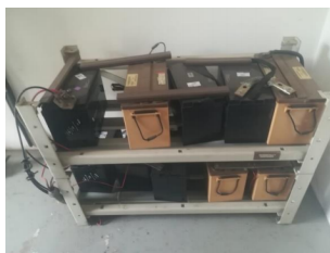
Figura 7: Banco de baterías
